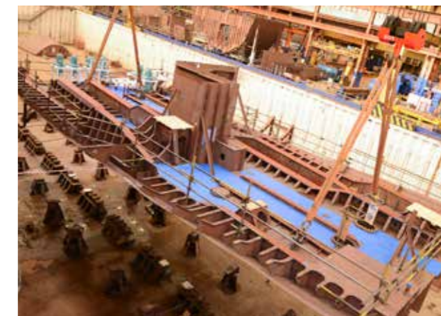
Construcción de la Quilla Del «Lé George Bernard Shaw», Cuarto Patrullero de Altura Del INS
